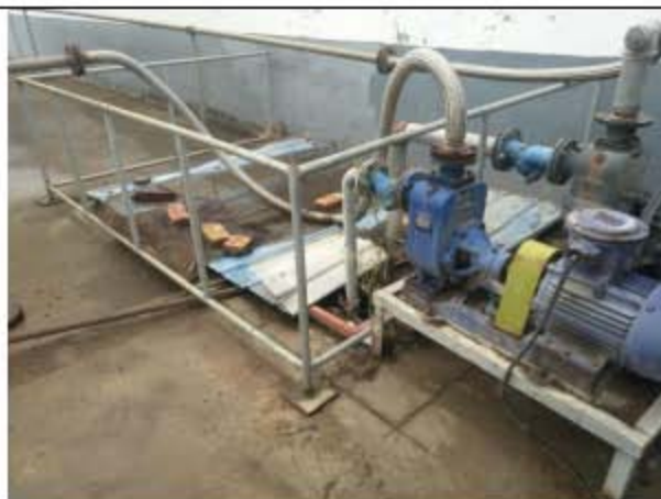
西厂区物料传输泵
