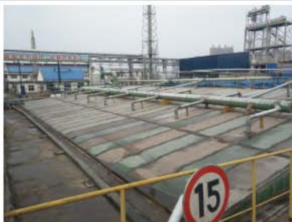
西厂区污水处理设施照片
