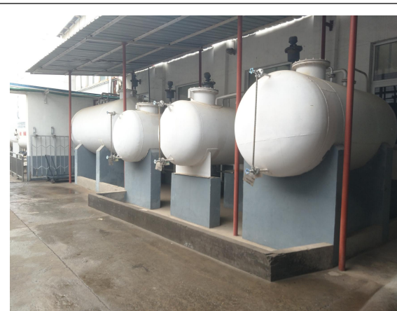
西厂区悬挂储罐
