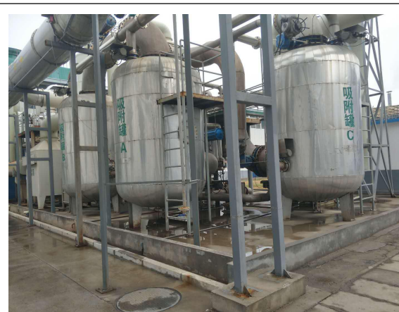
西厂区悬挂储罐
