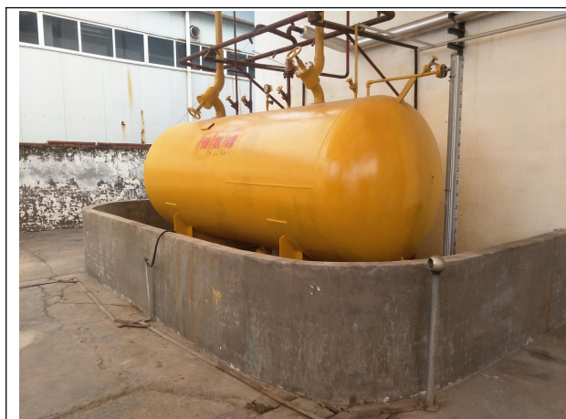
液氮储罐（东厂区）
