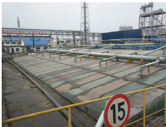
污水处理设施
