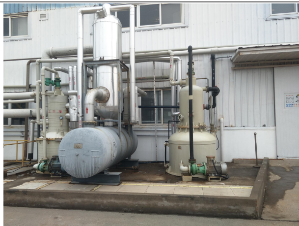
东厂区悬挂储罐
